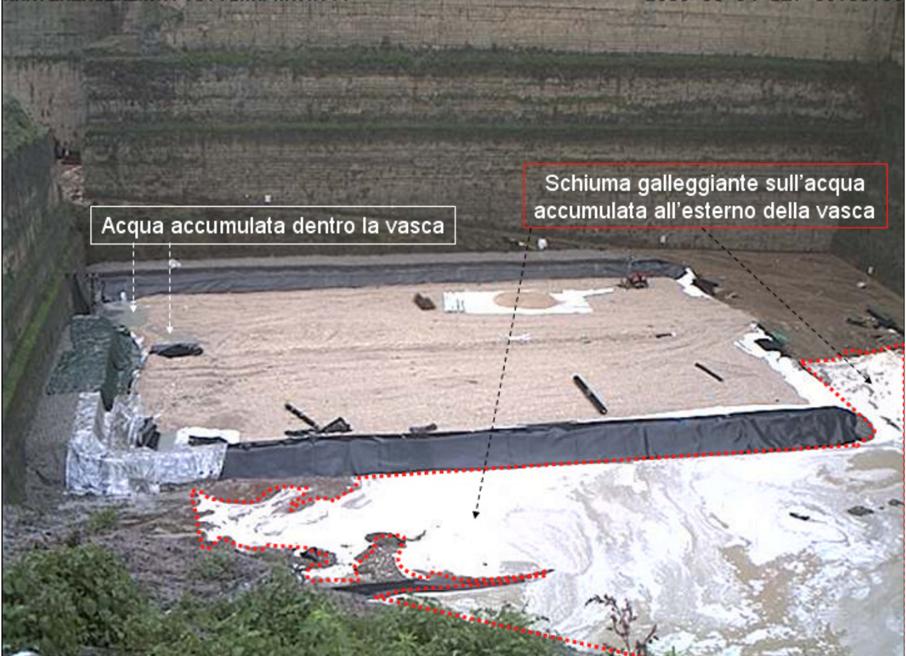
Figura 8: ulteriore allagamento del piazzale di cava con incremento della schiuma (delimitata dalla linea rossa punteggiata) galleggiante sull'acqua accumulata sul piazzale di cava (immagine tratta dalla web cam il giorno 14 gennaio alle ore 11,19)
