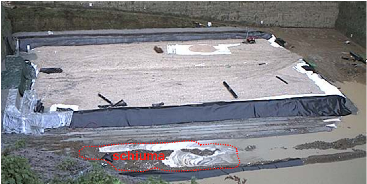
Figura 7: schiuma galleggiante da molti giorni sull'acqua accumulata sul piazzale di cava (immagine tratta dalla web cam il giorno 13 gennaio alle ore 14,14
