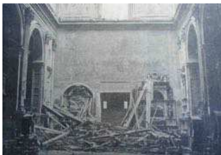
Fig. 55: Il crollo di parte della copertura dovuto al fulmine del 1 settembre 1920 (tratto da ANGELUCCI, Dopo 400 anni ).
