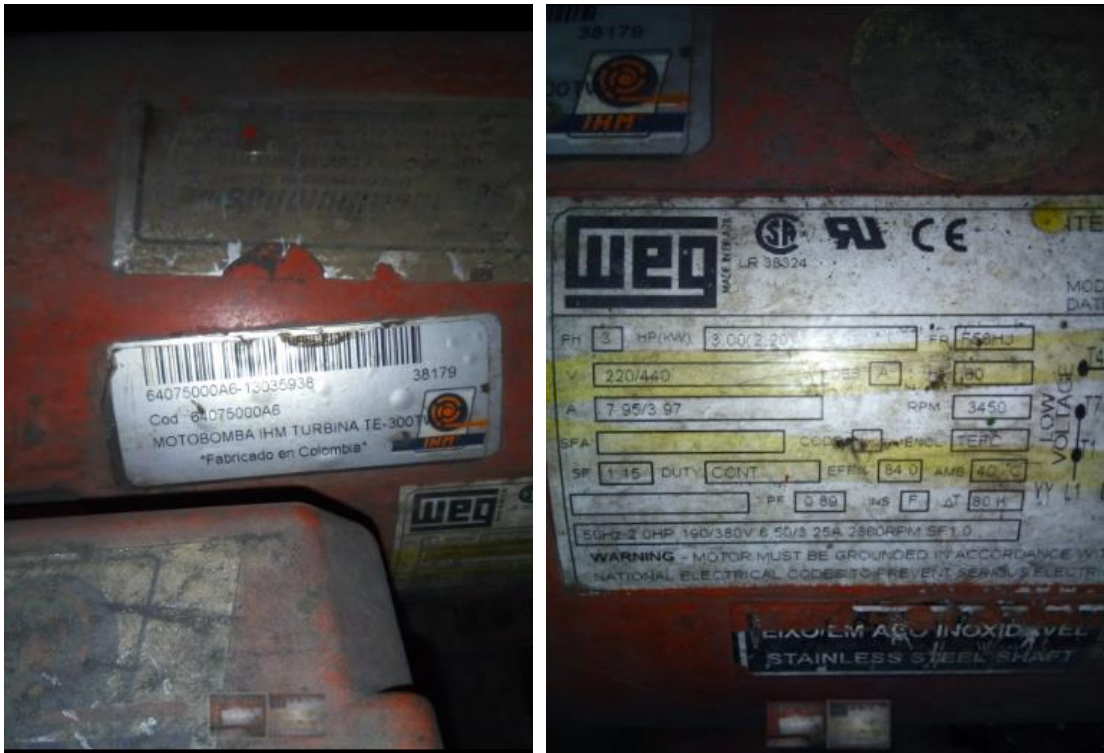
Figura 22: Placa de características de la bomba de la caldera.
