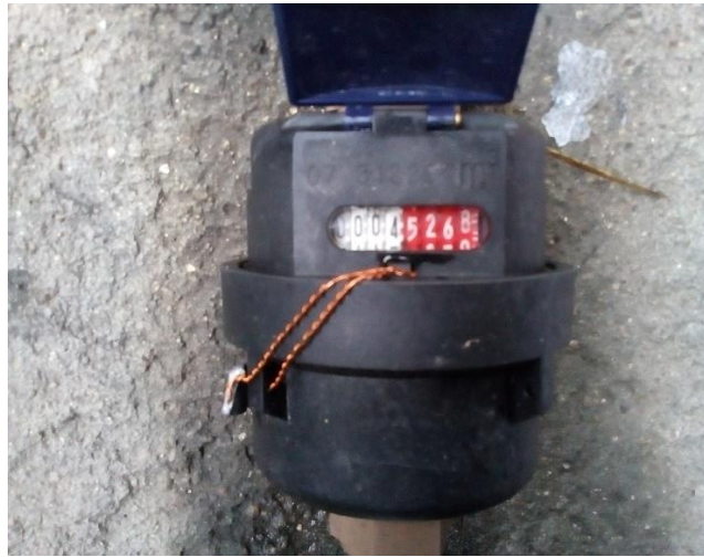
Figura 38: Contador de agua para el consumo de la caldera.
