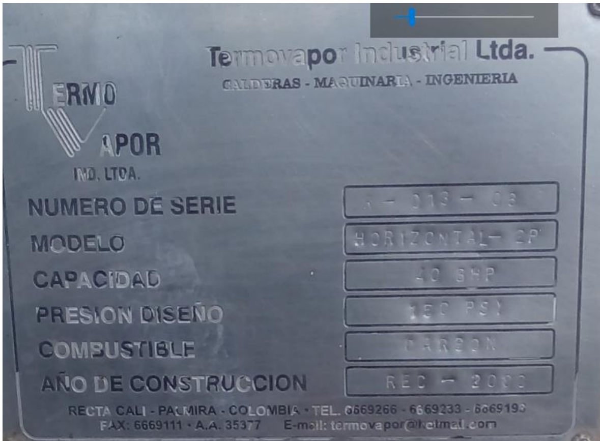
Figura 18: Datos de placa de la caldera de súper cerdo
