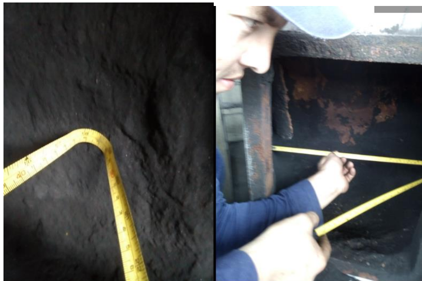
Figura 37: Medición del diámetro de la chimenea de la caldera.
