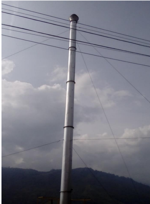
Figura 1: Chimenea para evacuación de gases de una caldera pirotubular
