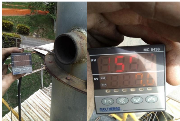
Figura 39: Dato de temperatura tomado en la chimenea de la caldera
