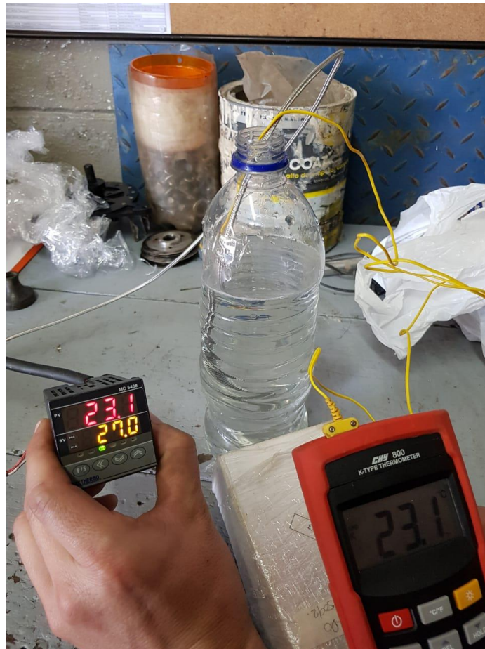
Figura 42: Toma de temperatura del agua de la caldera.
