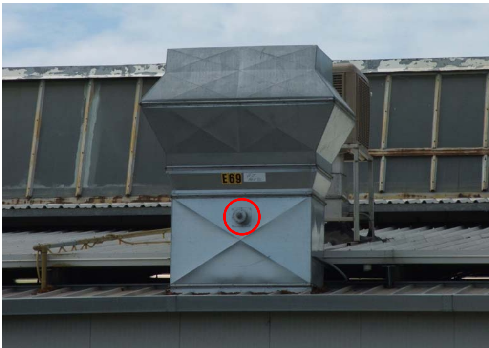
Fig. 1: emissione dotata di punto di campionamento posto in posizione non corretta: tratto rettilineo a valle del bocchello di campionamento troppo breve.
