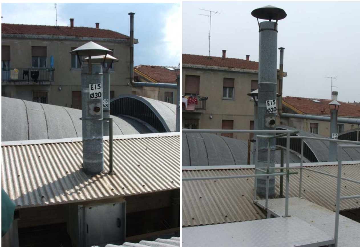
Fig. 22: percorso di accesso in quota al punto di prelievo: nella prima immagine, postazione di lavoro e percorso di accesso assente; nella seconda immagine, corretta disposizione.
