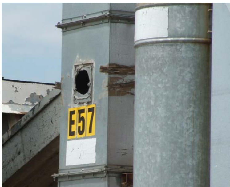
Fig. 6: emissione dotata di punto di campionamento privo di bocchello: bocchello distaccato dalle pareti del camino.
