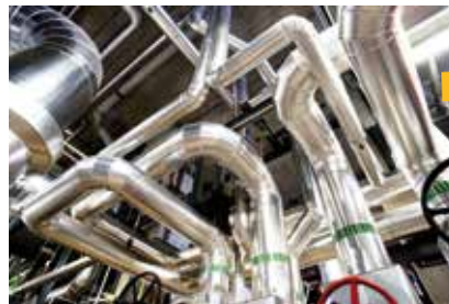
Nelle imprese industriali gli accumulatori vengono generalmente impiegati per l'energia termica necessaria ai processi industriali.
