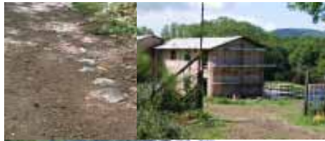
La sterrata che porta all'edificio dalla via Anagnina, probabili resti, ai margini del sentiero, di un'antica via forse romana o medievale. Due foto dello scheletro "tamponato"
