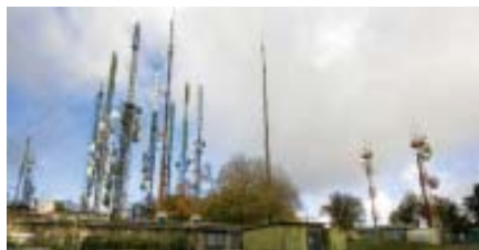
Antenne a Monte Cavo
