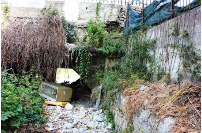
Figura 21. Lo stato miserevole del ponte della Madonna seminterato e coperto da rifiuti e spazzatura.
