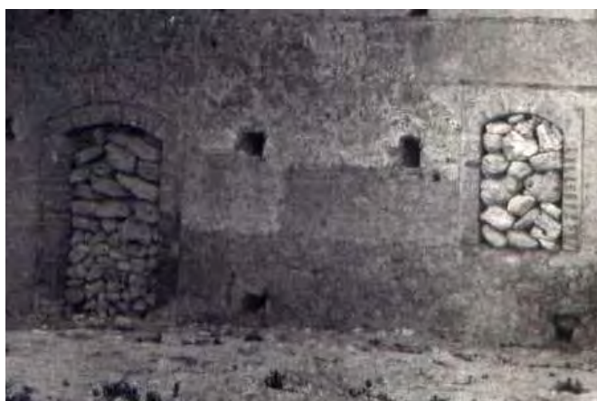
Figura 40. Grandi e piccoli conci grossolanamente squadrati e pietre informi che furono inseriti nell’edificio di Giuseppe Pollicino per chiudere i varchi di una porta e di una finestra (ingrandimento della Figura 14).
