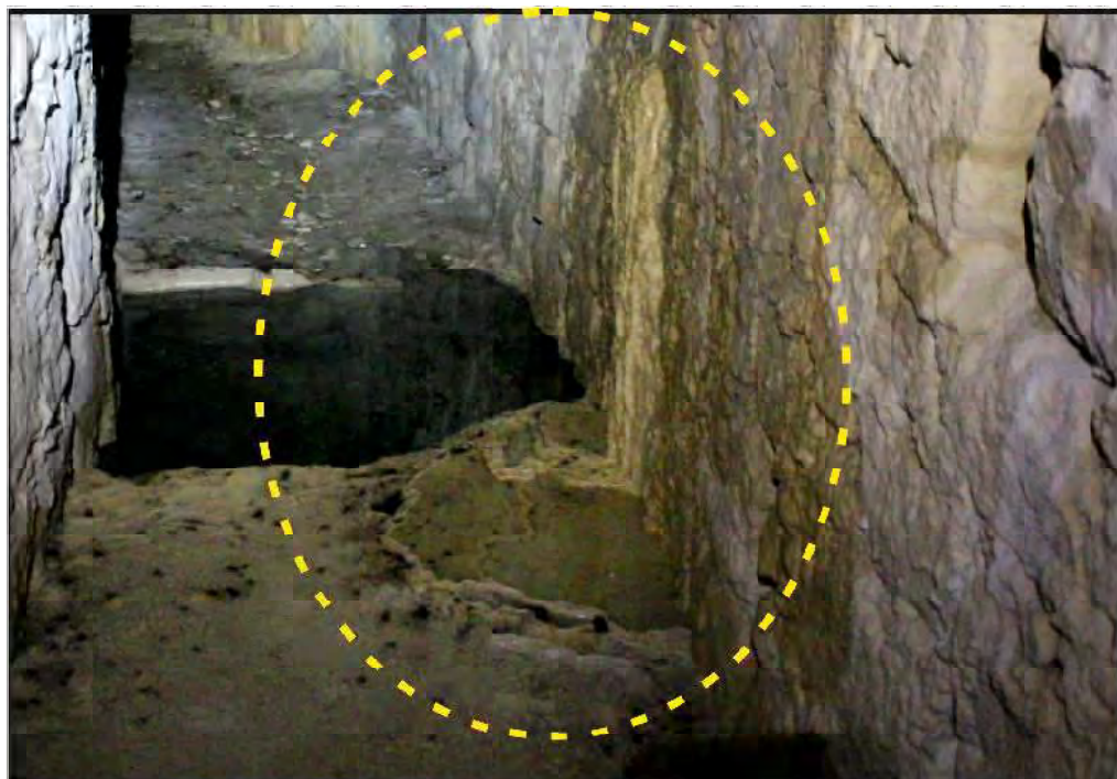
Figura 28. Feritoia con concrezioni calcaree di circa 8 cm a pavimento.
