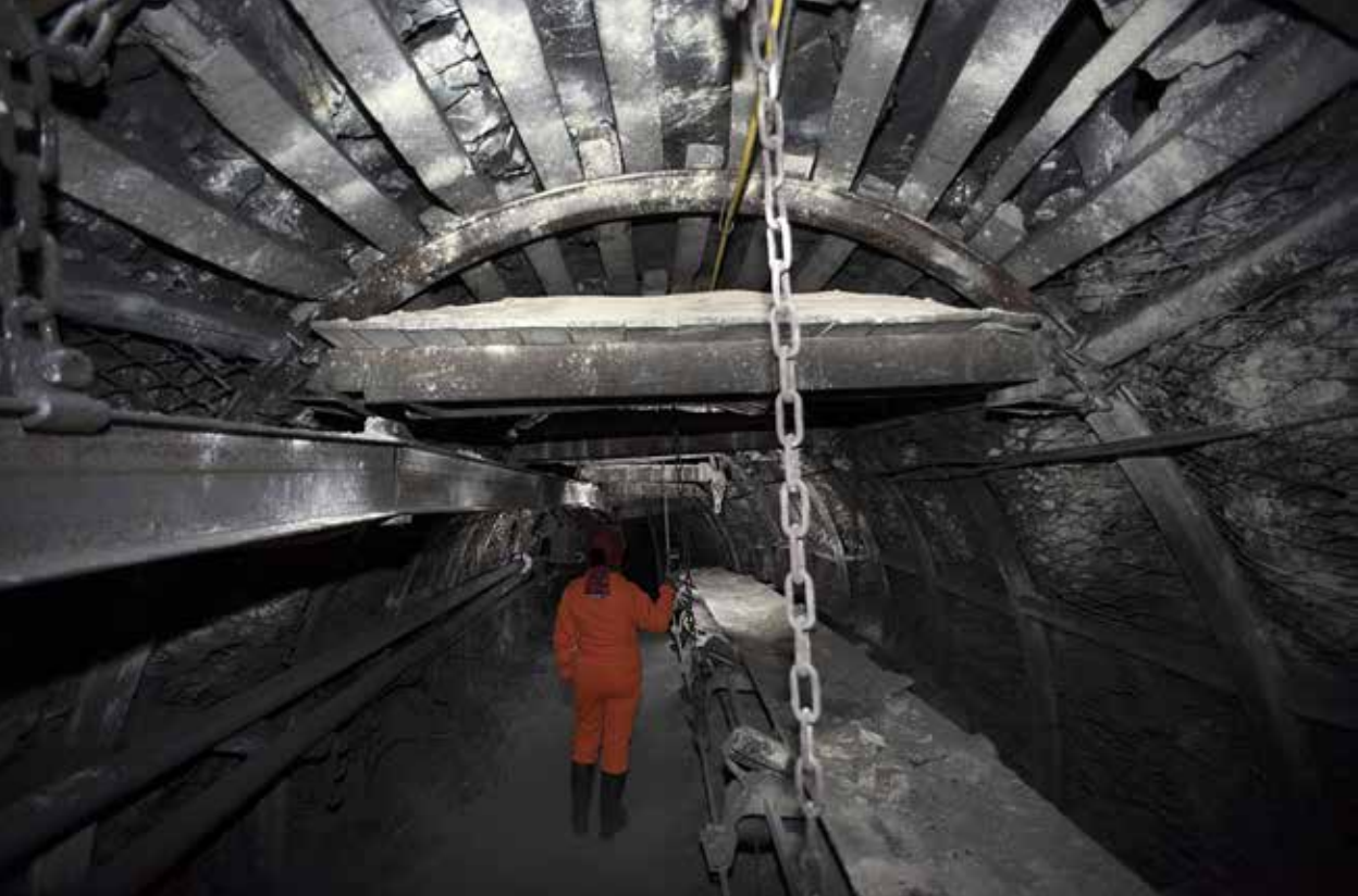
Kopalnia Guido: discenderia verso il livello -355. Si notano il lungo nastro trasportatore e i depositi di polvere, per abbattere il fronte del fuoco in caso di incendio. (foto G. Belvederi).
