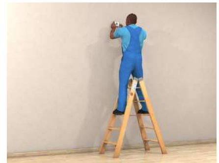
Fig. 56 Stare in piedi in sicurezza su una scaletta accessibile da entrambi i lati
